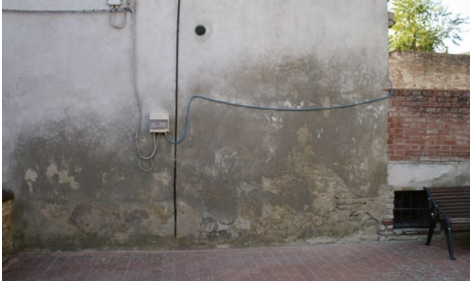
Veränderung der Farbe, Reduzierung der Wärmedämmung
