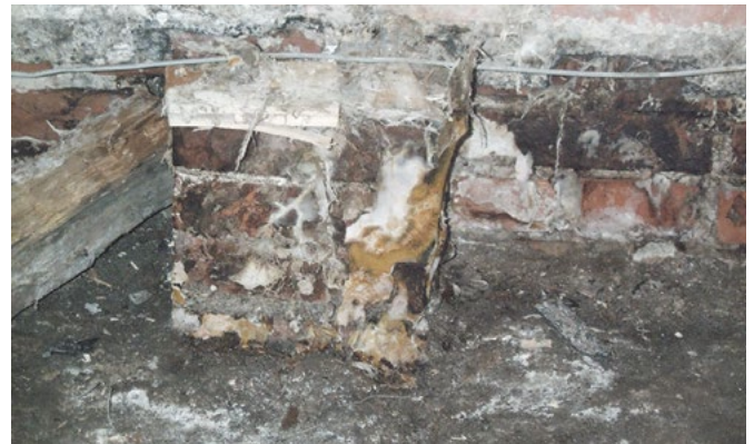
Begünstigung von Schimmel, Pilzen und Schädigung der Bausubstanz
