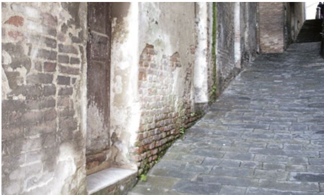
Zerstörung des Putzes und der Mörtelfugen
